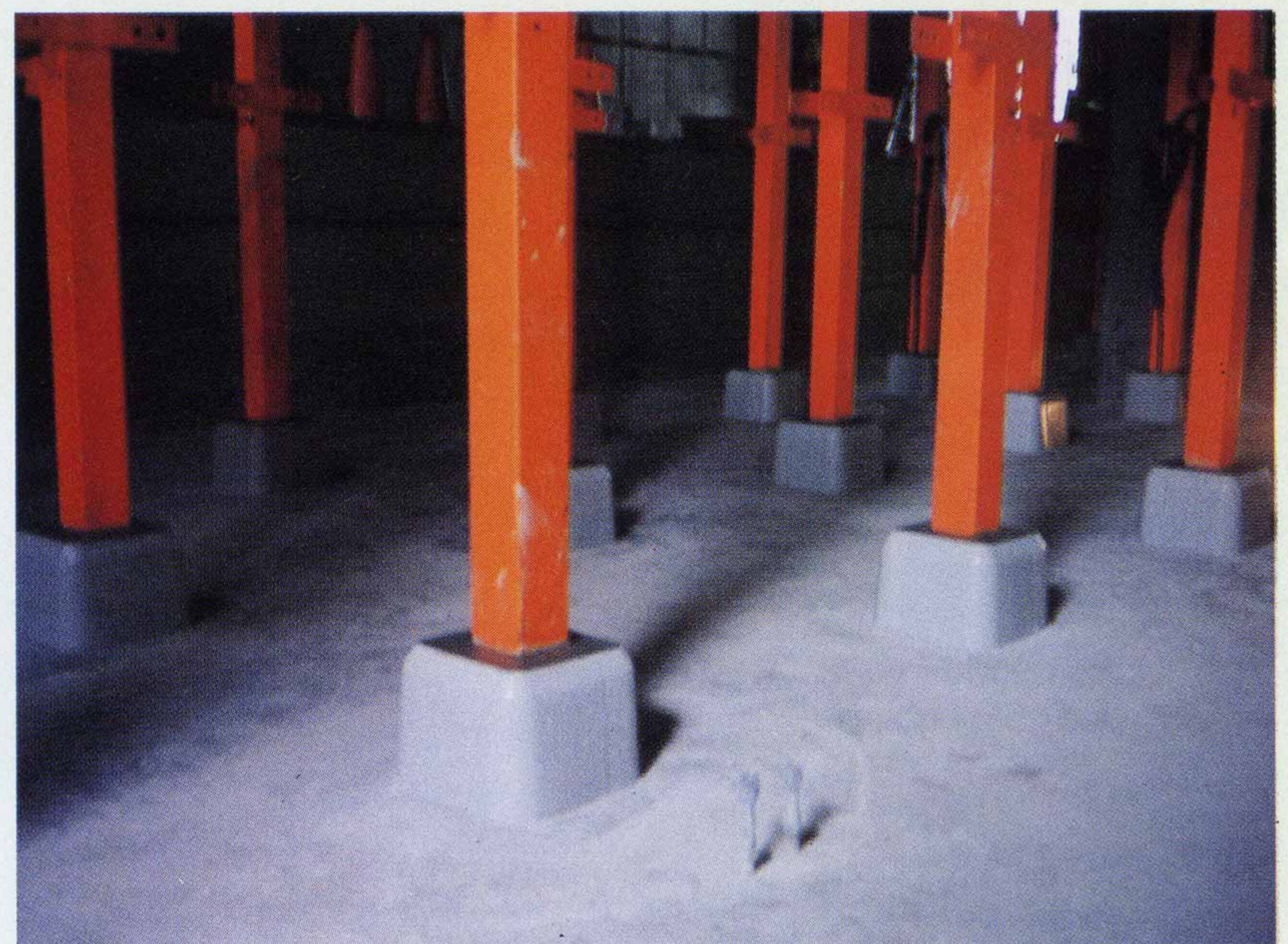
静岡変電所現場内
